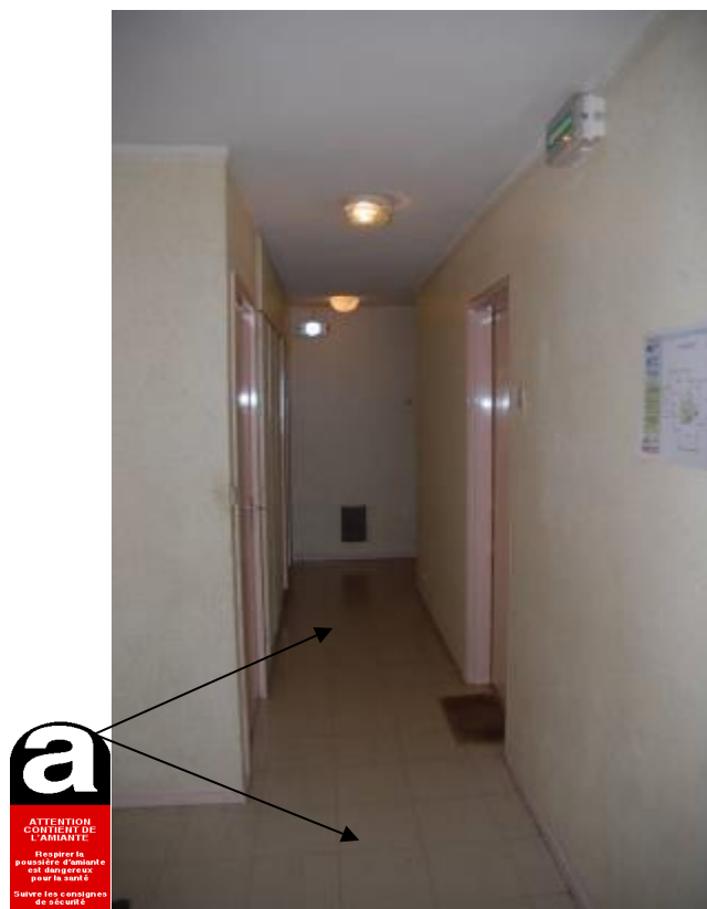
Dalles de sols vinyle amiante des circulations 5ème étage
