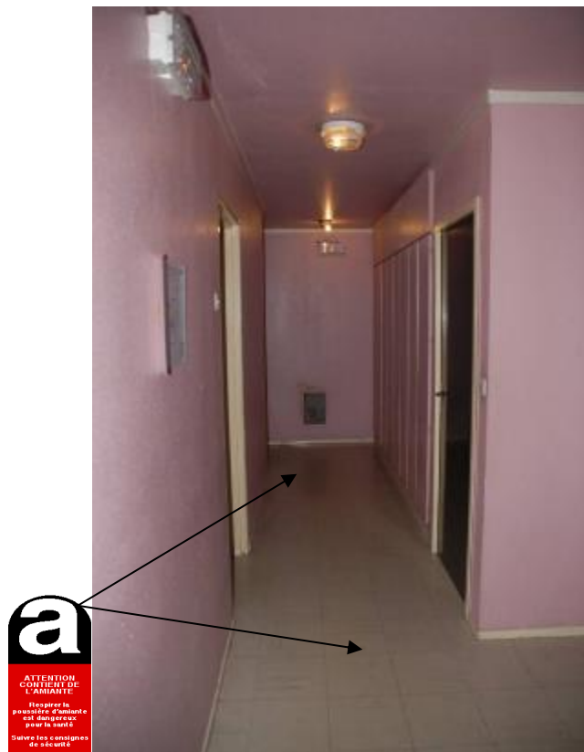
Dalles de sols vinyle amiante des circulations 1 er étage
