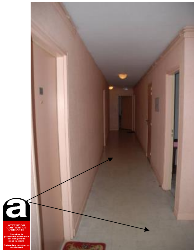
Dalles de sols vinyle amiante des circulations 3ème étage
