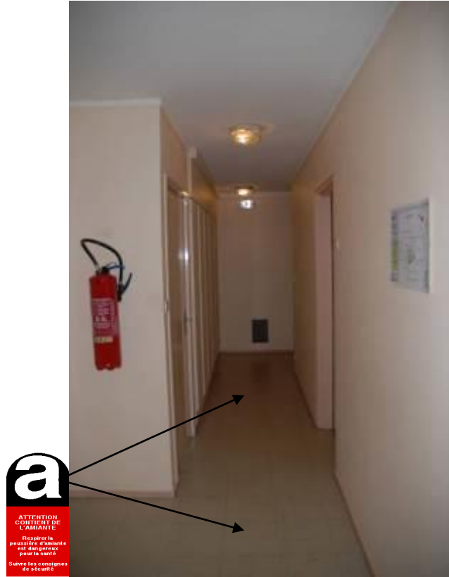
Dalles de sols vinyle amiante des circulations 6ème étage
