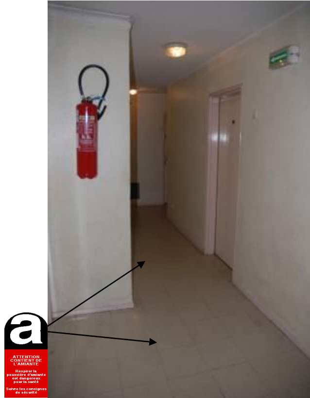
Dalles de sols vinyle amiante des circulations 8ème étage
