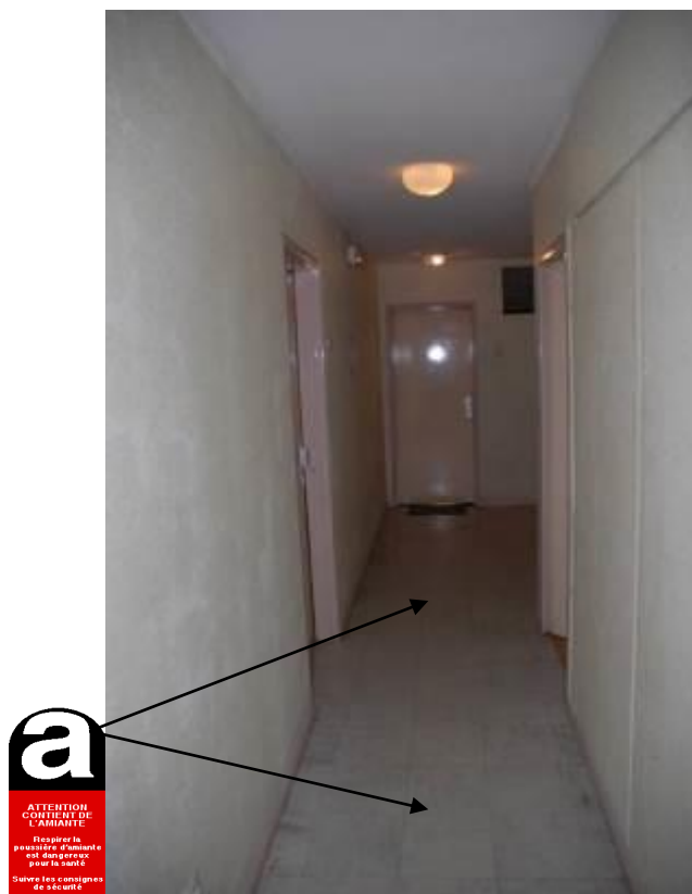
Dalles de sols vinyle amiante des circulations 9ème étage
