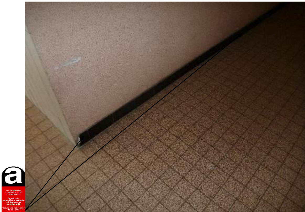
Colle amiantée plinthes carrelage sol entrée Florian
