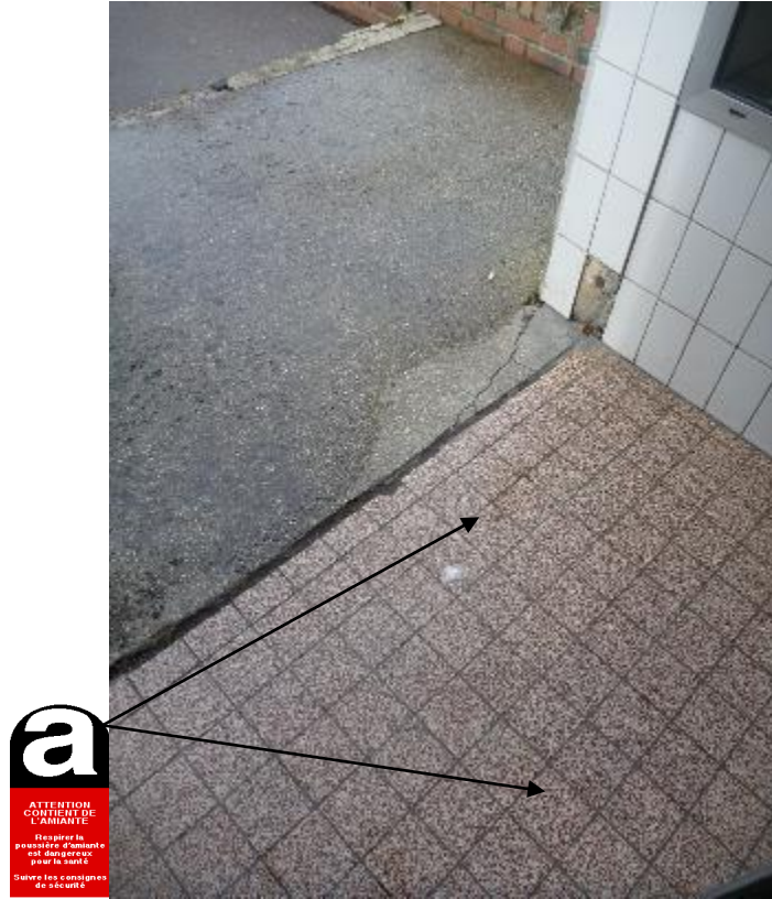
Colle amiantée carrelage sol entrée Florian
