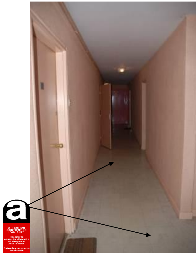
Dalles de sols vinyle amiante des circulations 2ème étage
