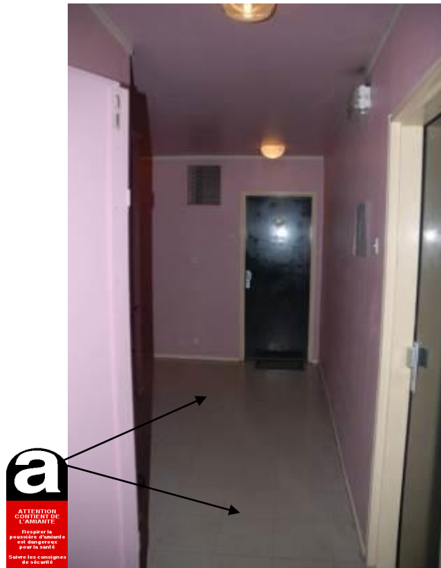
Dalles de sols vinyle amiante des circulations 7ème étage
