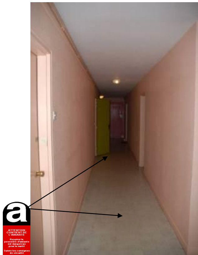
Dalles de sols vinyle amiante des circulations 4ème étage
