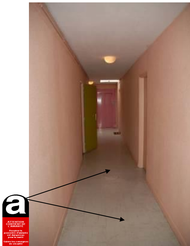
Dalles de sols vinyle amiante des circulations 5me étage
