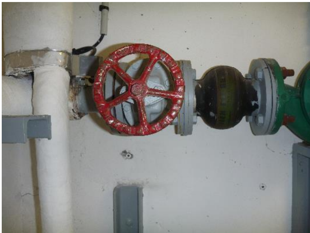
Vanne au fond de la sous-station
