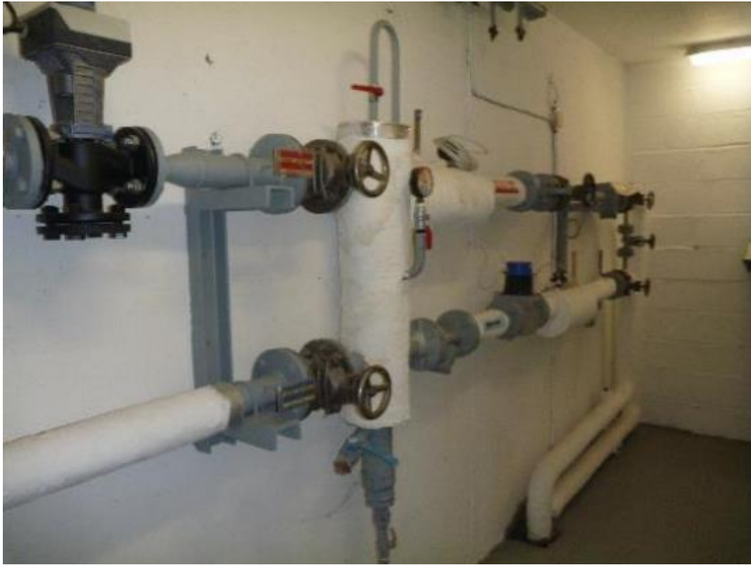
Sous-station de l'immeuble Florian
