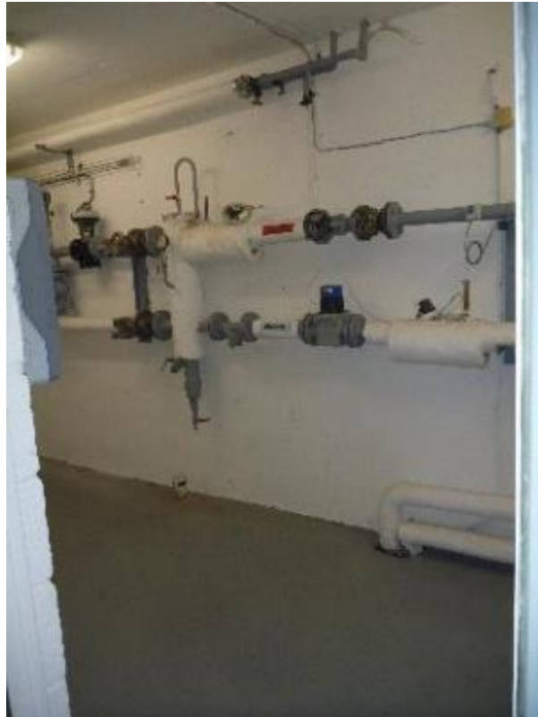
Sous-station de l'immeuble Florian
