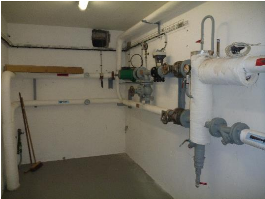
Sous-station de l'immeuble Florian
